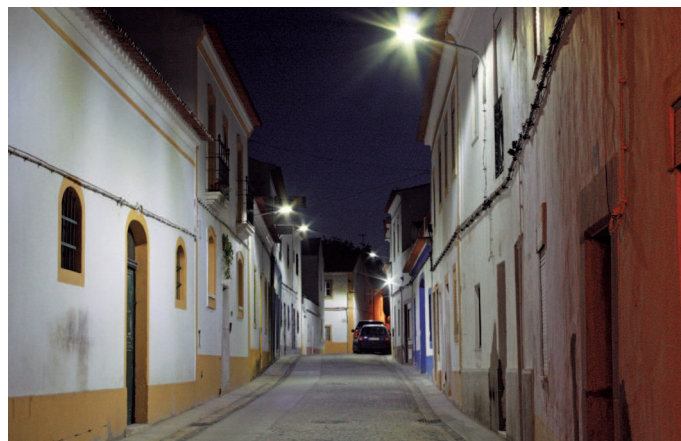
Instalação de 127 luminárias tipo led com melhor iluminação e redução cerca de 60% do consumo
